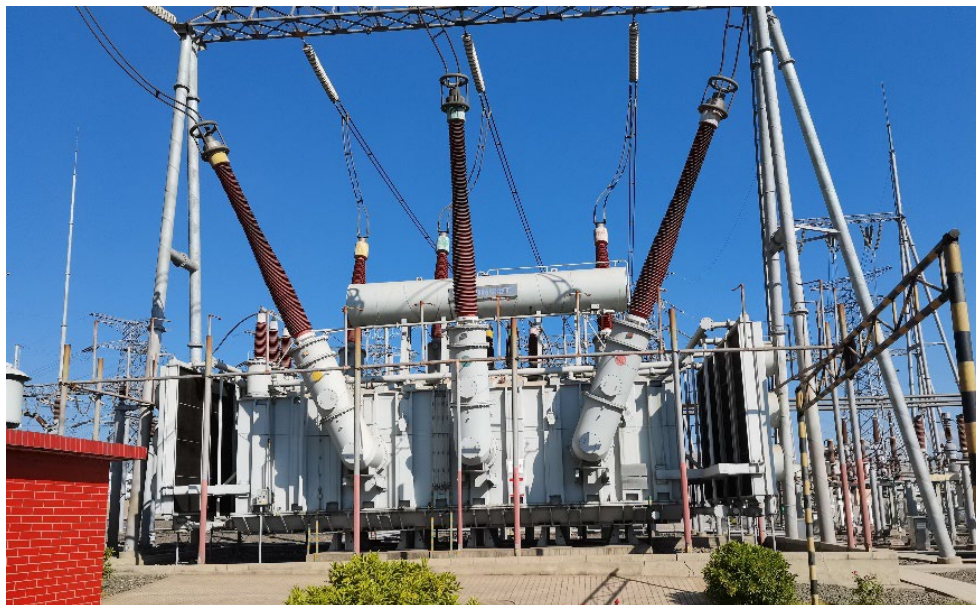
图 2.1 500 kV 三相一体变压器实物图
