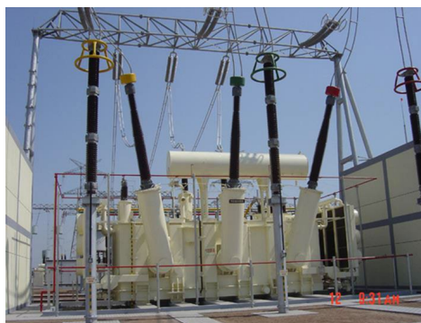
(a) 某站大型电力变压器
