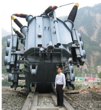
(a) 大型变压器倾覆破坏
