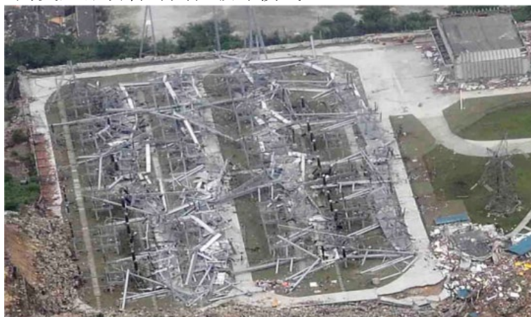
(a) 二台山变电站震后受损情况
