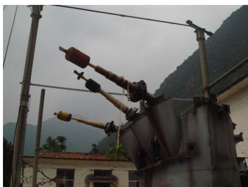
(c) 变压器套管漏油起火
