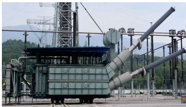
(b) 某站换流变压器
