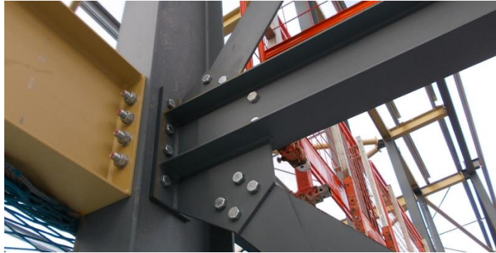
图 1.2 钢结构节点处的螺栓连接
