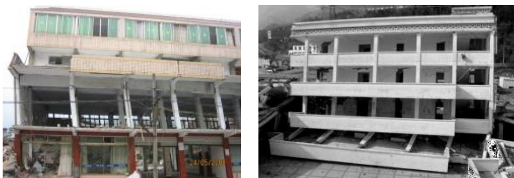
(a) 汶川地震中混凝土框架典型破坏模式 (b) 汶川地震漩口中学教学楼倒塌
