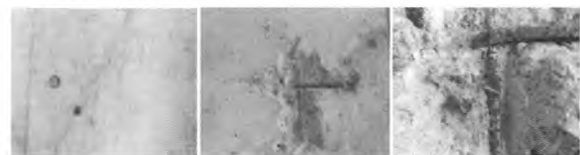
(a) 混凝土表面裂缝 (b) 保护层剥离情况 (c) 钢筋腐蚀情况
